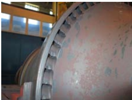
Rys. 3. Uszkodzone łopatki kąta regulacyjnego
