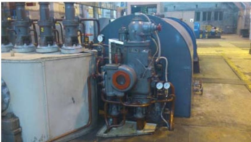
Rys. 1. Turbina PB8/4 przed modernizacją
