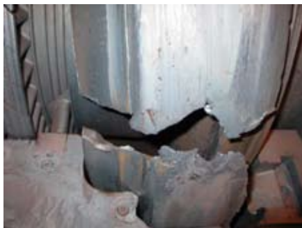
Rys. 5. Uszkodzony pierścień kierujący kąta regulacyjnego
