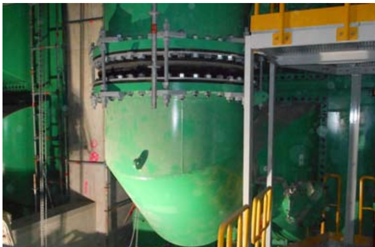
Rys. 11. Widok nawrotnej komory wodnej kondensatora
