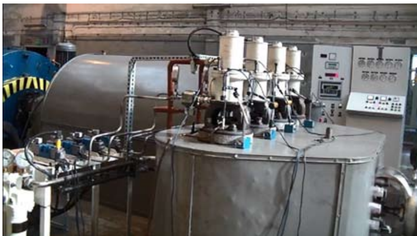
Rys. 2. Turbina PB8/4 po modernizacji
