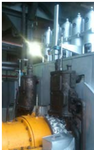
Rys. 5. Turbina Siemens 55 MW przed modernizacją
