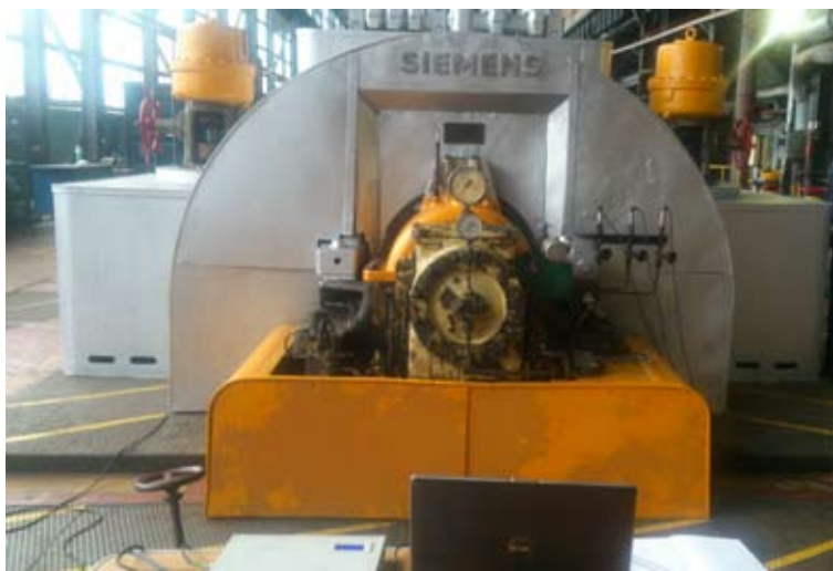
Rys. 4. Turbina Siemens 55 MW przed modernizacją
