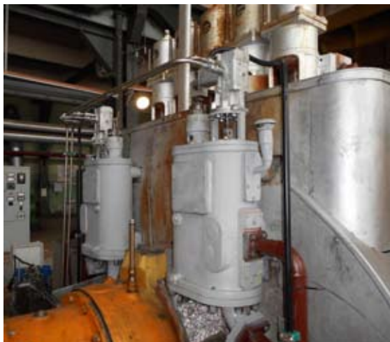
Rys. 6. Turbina Siemens 55 MW po modernizacji
